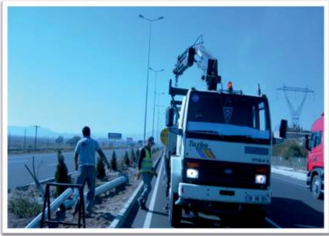
Boğazköprü –İncesu Arası Aydınlatma Direkleri
