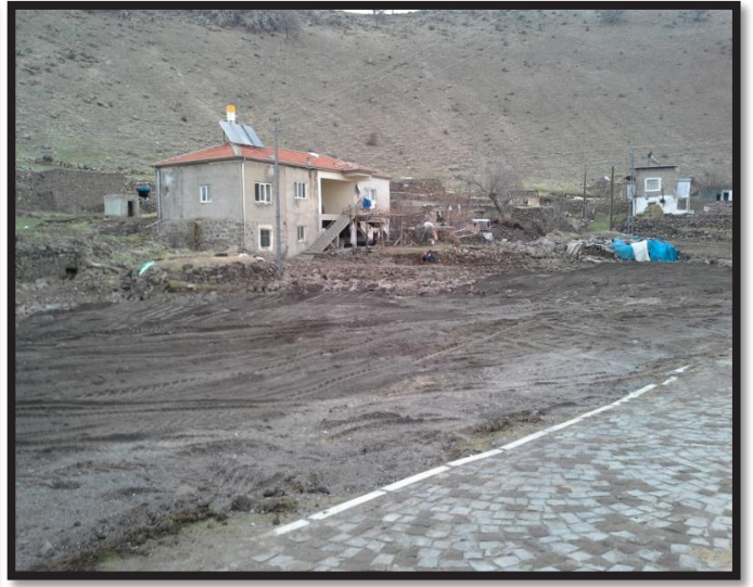
Hanyeri'nde tehlike arz eden eski binaların temizlenmesi
