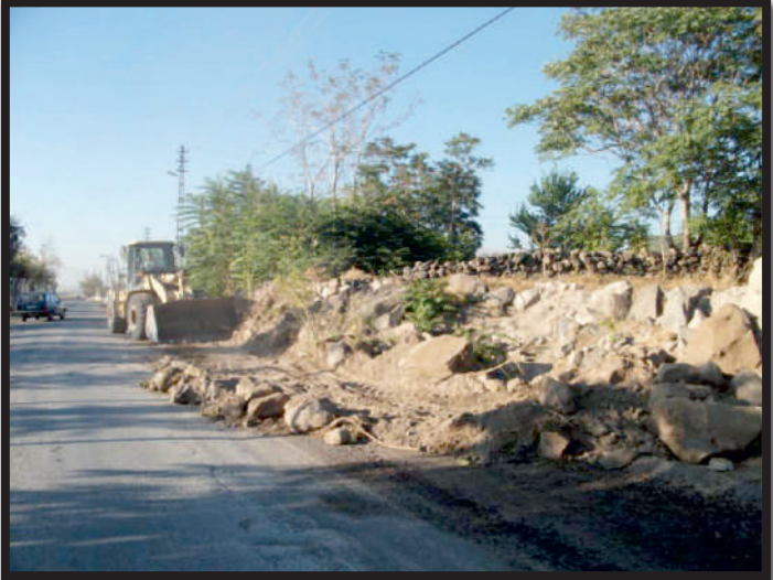
Bahçelievler Mahallesi İstasyon caddesinde sıcak asfalt öncesi yol düzenleme ve genişletme çalışmaları
