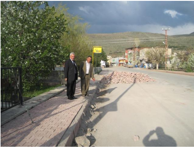
Kızılören Cumhuriyet caddesinde bulunan Parlaklar ilköğretim okulu önüne 500m yaya kaldırımı yapıldı
